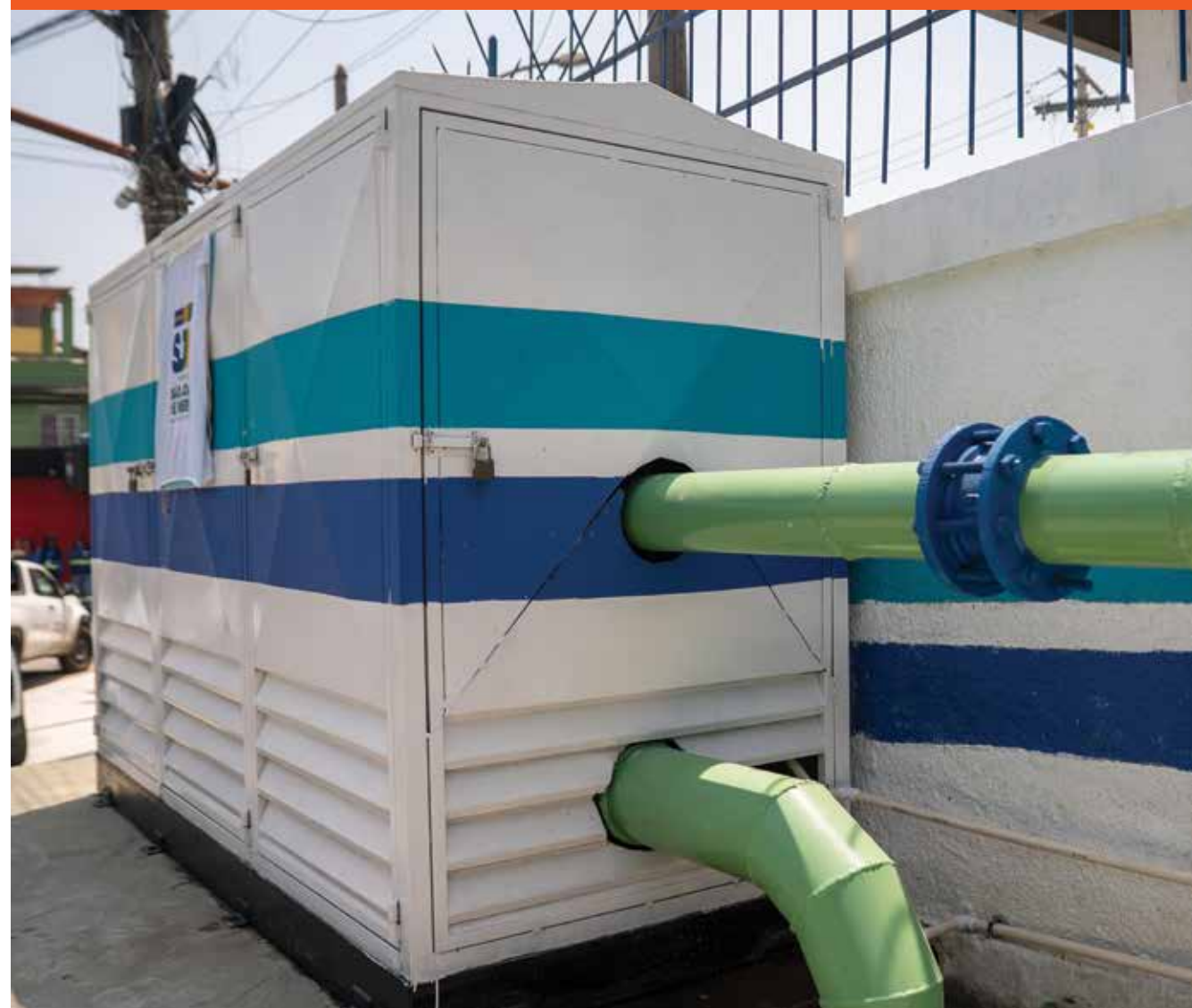
Bomba d'água instalada pela Águas do Rio na Vila São João. Crédito: divulgação
